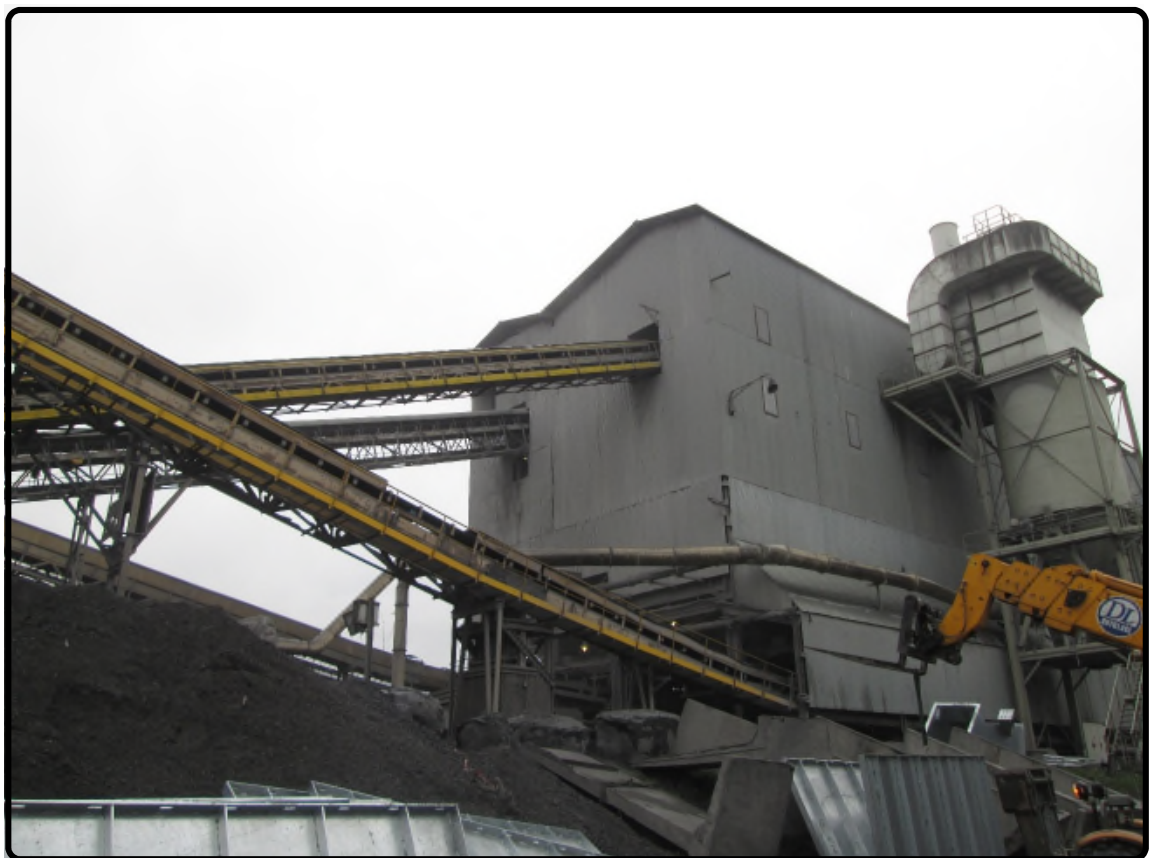
Installation de l'entrée du traitement tertiaire avant juin 2016
