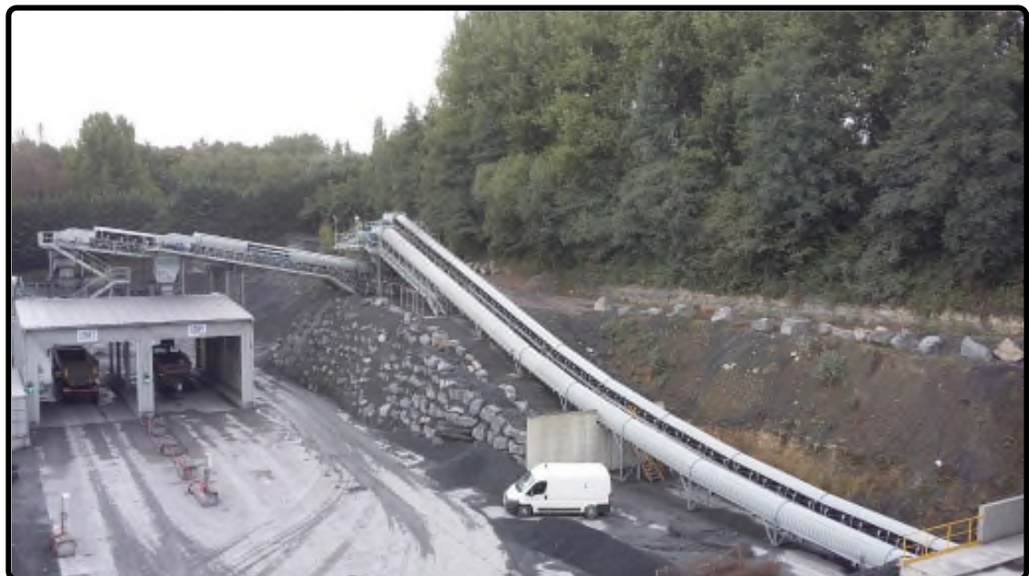
Vue des convoyeurs alimentés par les silos de stockage en direction du chargement
